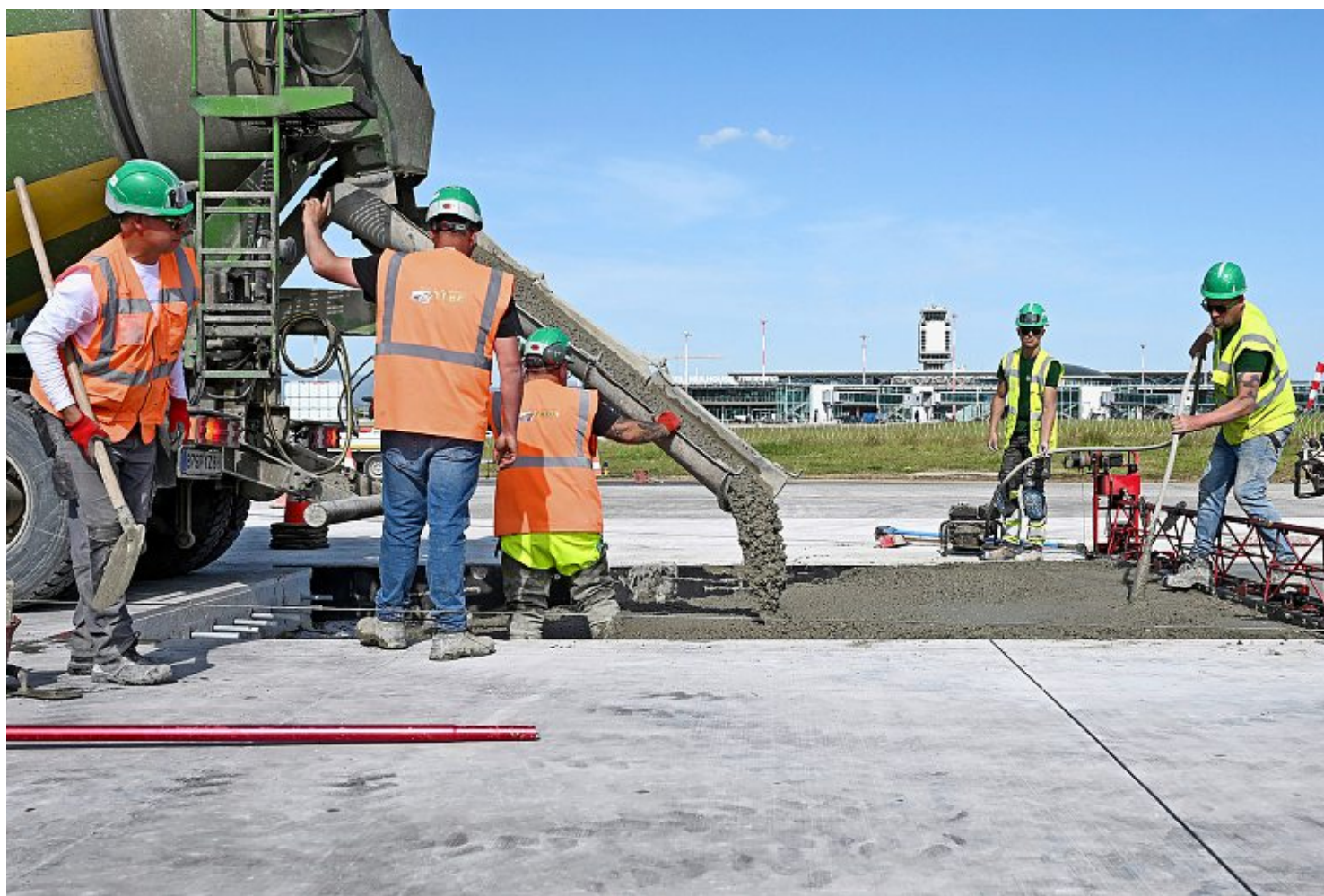
Die Hauptpiste des Flughafens Basel-Mulhouse (Euro-Airport) wird einer umfassenden Sanierung unterzogen. Foto: Pino Covino
